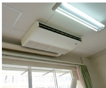
快適な学習環境を確保するた め、市内公立小・中学校の全教 室に設置されている教室エアコ ン(写真は住道中学校)
