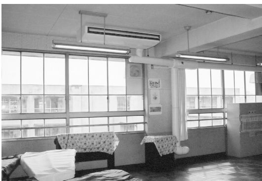
エアコンが設置された音楽教室
