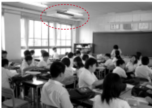
評判のよい中学校の冷暖房設備（住道中学校）
