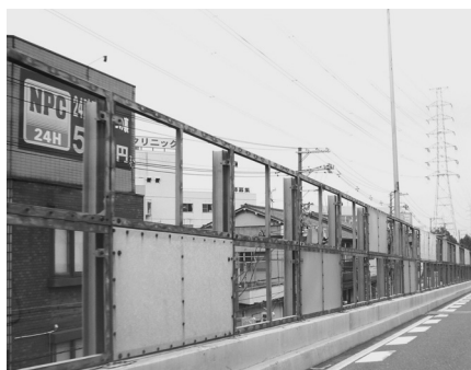
早期の整備が望まれる野崎跨線橋西側の防音壁。
