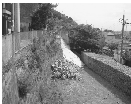
崩落した状態の北条小学校校門近くの石垣。同校東側の石垣は早期の調査・修復が望まれる。
