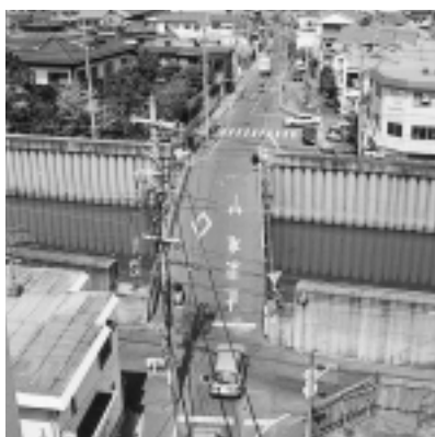
改修が待たれる三箇大橋
