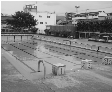
平成22年度に改修工事の着工が予定されている住道南小学校のプール
