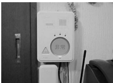
ひとり暮らしの高齢者宅に設置されている緊急通報システムの通報装置
