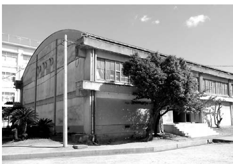
早期の改修工事の実施が望まれる南郷中学校体育館
