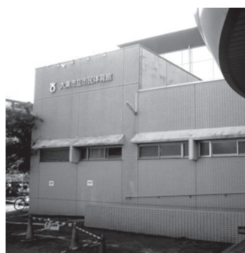
早期の非構造部材の耐震化が望まれる市民体育館(寺川1丁目)
